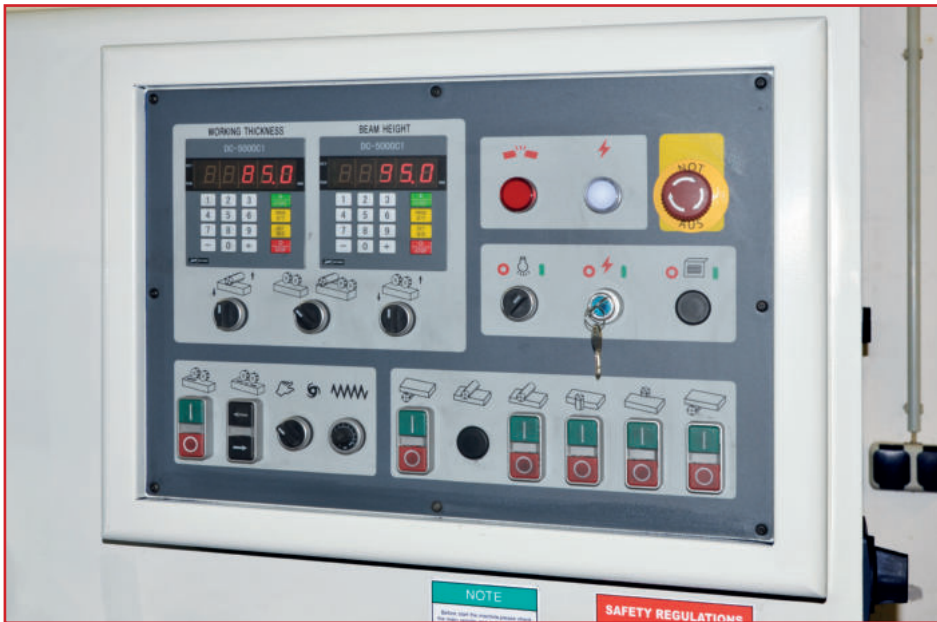
Steuerpult mit SPS Steuerungen für Hobelhöhe und Geschwindigkeit,
